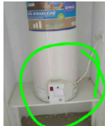
Pérdida de agua arreglada.
